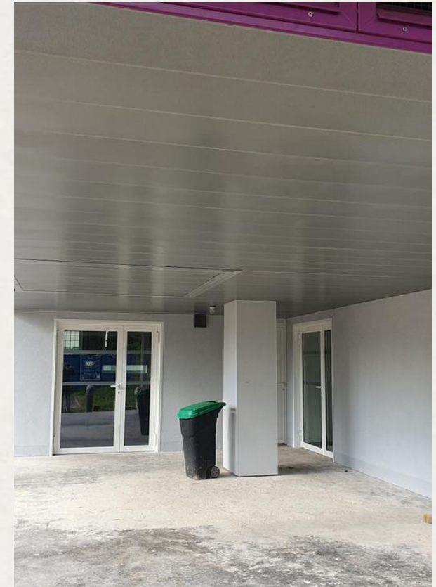
Porte en DV et intégration de la CTA RDC
