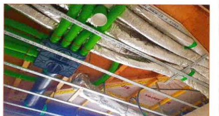
Le réseau de gaines en PEHD calorifugées a dû être doublé pour permettre d'atteindre des débits suffisants pour le refroidissement par la PAC air/eau Hitachi.
