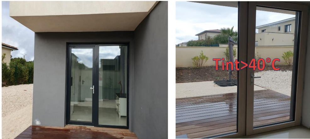
PORTE ENTRÉE PROTECTION SOLAIRE INSUFFISANTE
